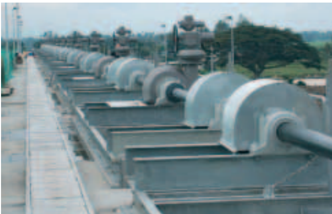
马来西亚的灌溉项目, 使用的是大型的没有限位的多回转执行器GS齿轮箱。例图工厂所显示的是水渠堰是怎样被控制的。
